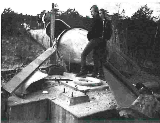
Markfundament och fallen mast
